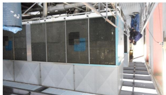
Figura 4.13 - Particolare dei gruppi frigoriferi di centrale termica
