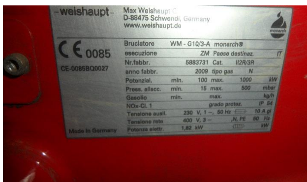
Figura 4.10 - Particolare del bruciatore di caldaia
