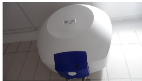
Figura 4.12 - Particolare di un boiler elettrico per la produzione di acqua calda sanitaria
