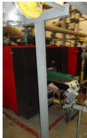
Figura 4.11 - Particolare delle caldaie di CT
